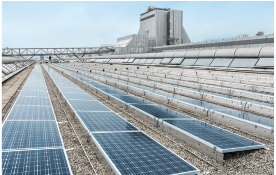
Plus grande qu'un terrain de football: l'installation photovoltaïque sur le toit du centre courrier de Zurich-Mülligen.
