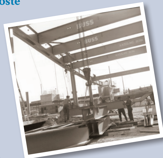
Ici, pas de demi-mesure: chantier du bâtiment de la Schanzenpost à Berne, en 1963.
