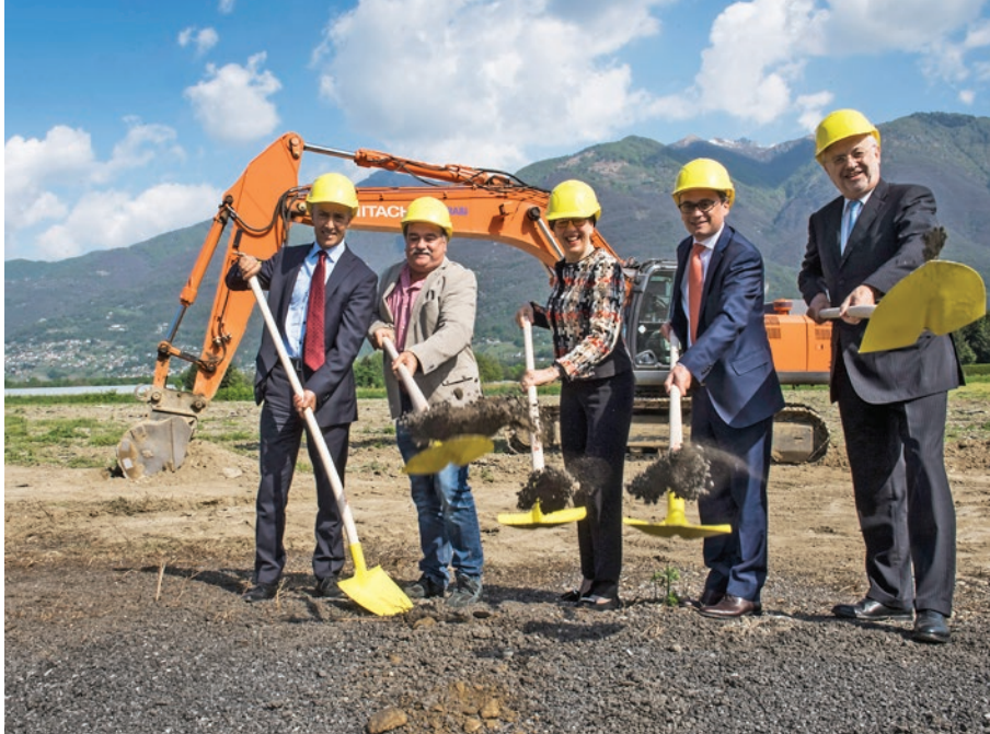
Premier coup de pelle pour le nouveau centre colis (de g. à d.): Rocco Cattaneo, CEO Stisa SA; Renzo Marielli, vice-syndic de Cadenazzo; Susanne Ruoff, directrice générale de la Poste, Christian Vitta, conseiller d'État du Tessin; Adriano Vassalli, vice-président du CA de la Poste.
