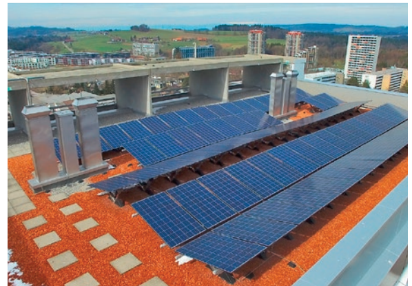
Le décompte d'électricité de cet immeuble locatif à Berne est effectué automatiquement par blockchain.
