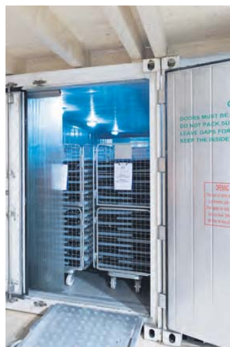
4 Les accumulateurs de chaleur sont placés dans des containers tempérés.
