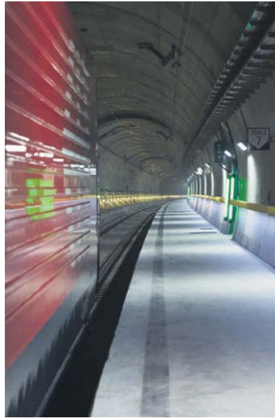
Tube Ouest du tunnel. Deux diagonales permettent aux trains de passer d'un tube à l'autre.
