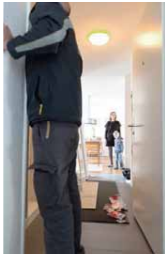
Der Schrank wird beim Kunden an der Verwendungsstelle montiert.
